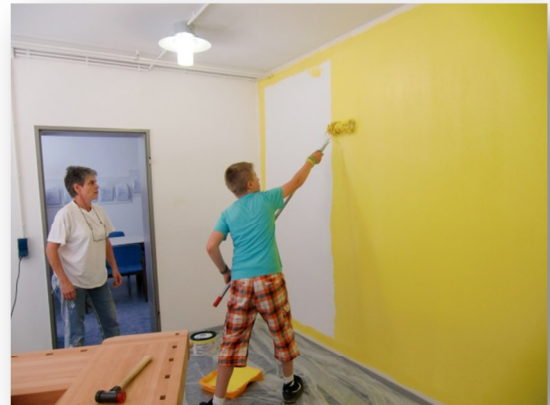
(Stefanie Rohe-Braun und Tom Heitmann beim Renovieren der Werkstatt im Keller des Eli)
